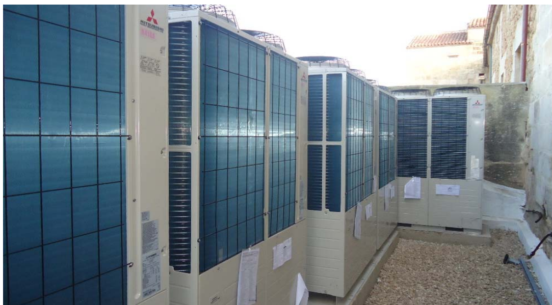
Nuevas máquinas exteriores.
