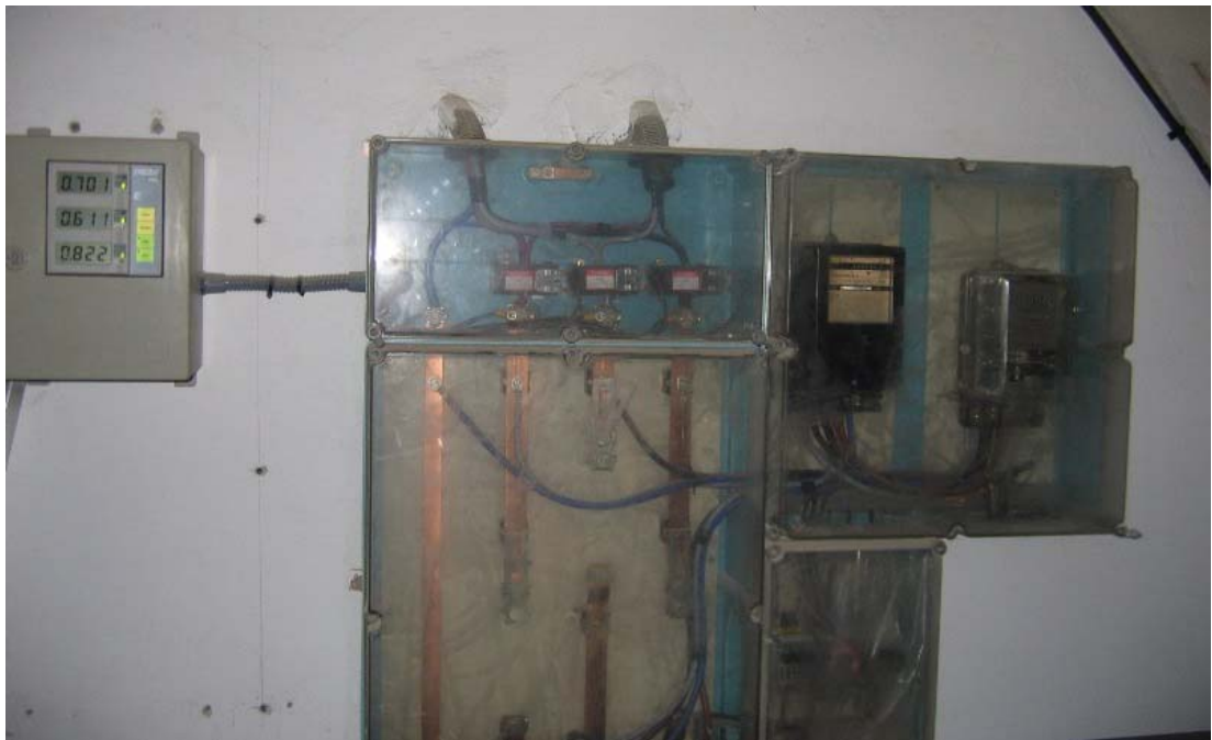
Estado del Cuadro General eléctrico.
