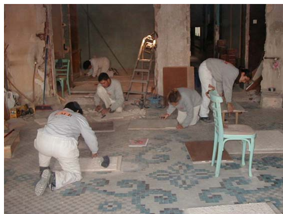
Operaciones de extracción del pavimento de la vivienda tras su donación por la familia Casanova al Museo Nacional de Cerámica.
