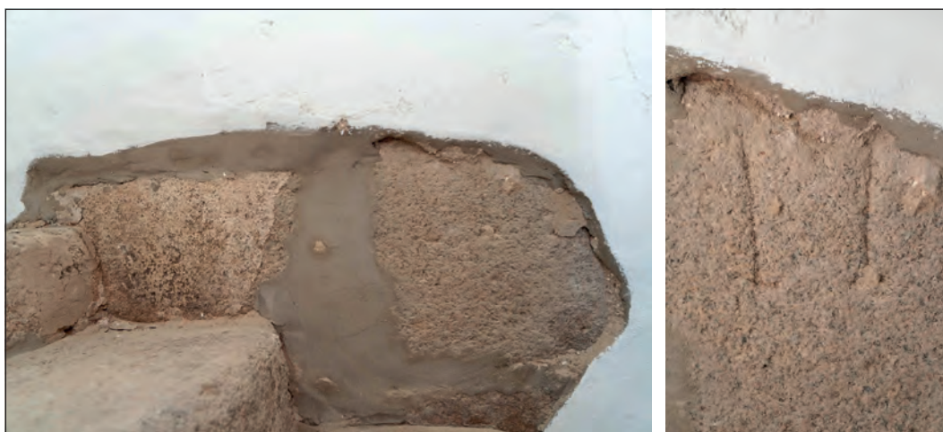
Fig. 2. Vista general y detalle del posible epígrafe en la escalera de acceso al coro alto (fotografía de Lorenzo Plana).
