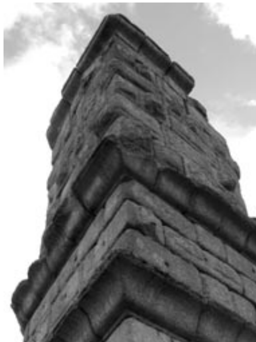
Fig. 10. Puente de Alconétar (Cáceres). Detalle de las cornisas correspondiente a la imagen anterior. © Los autores.
