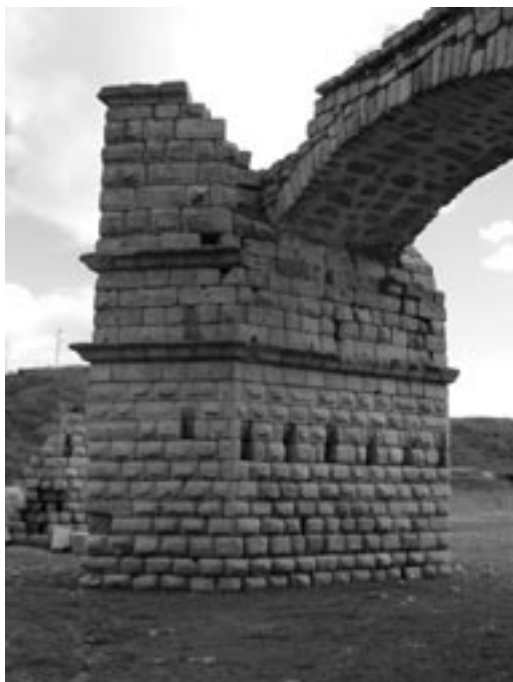
Fig. 9. Puente de Alconétar (Cáceres). Pilar más completo que ha llegado hasta nosotros, correspondiente a la zona de aguas arriba del río. © Los autores.
